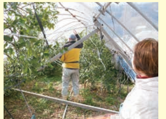
雪害を受けたビニールハウスを視察(2025年2月)
